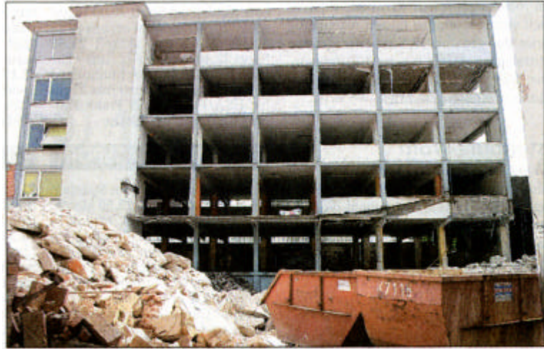
Die maroden Gebäude wurden vor dem Abriss regelrecht entkernt: Fenster und Böden kamen raus, bevor die Bagger anrückten.
